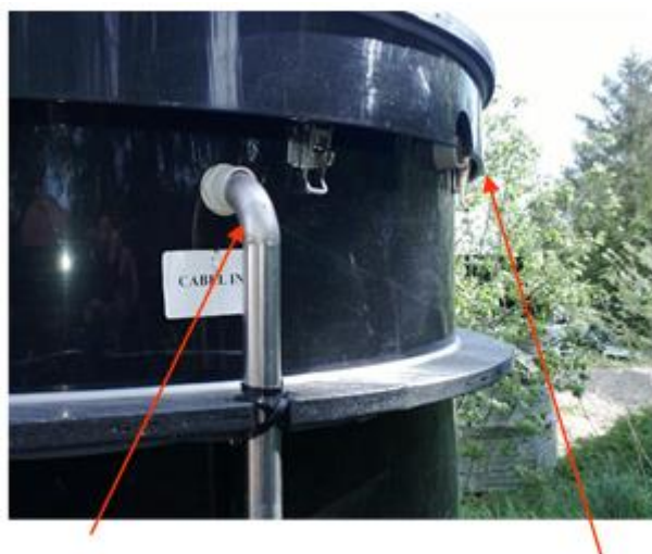
Kabelgenomföring till tekniklådan
