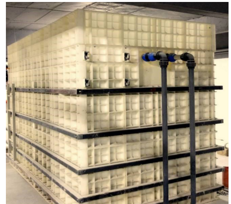
Jupiter A. G. installerad i en källarvåning på ett hotell
