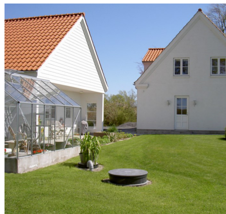
Pluto installerat vid ett enfamiljshus
