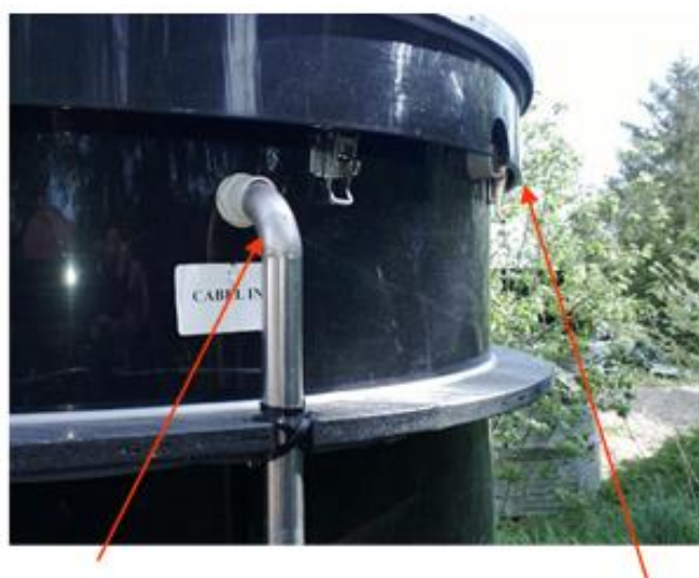
Kabelgenomföring till teknikenlådan
