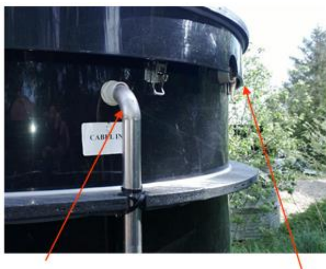
Kabelgenomföring till teknikenlådan
