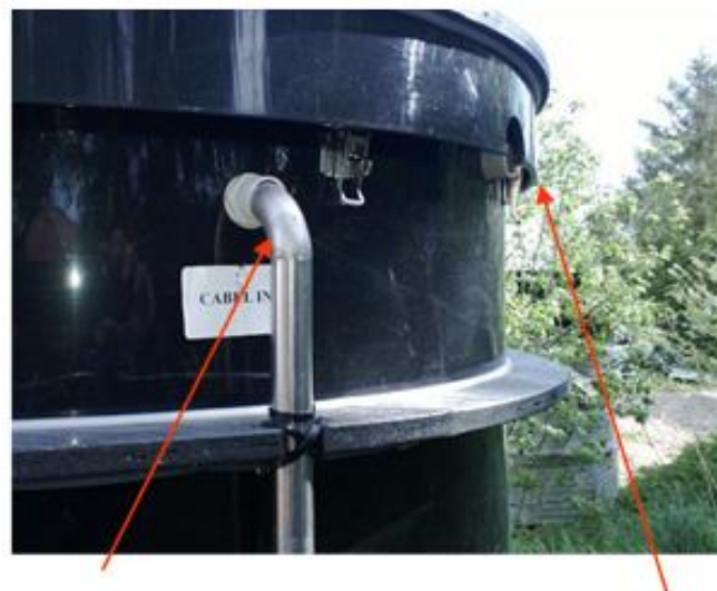
Kabelgenomföring till teknikenlådan
