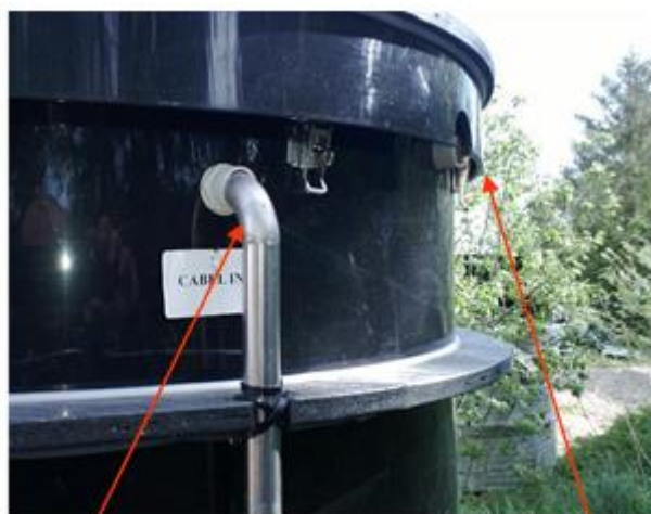
Kabelgenomföring till tekniklådan
