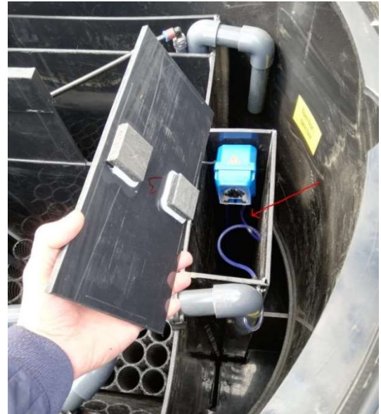
Bilden visar den inbyggda tanken för fosforutfällningsmedel med inbyggd doseringspump
